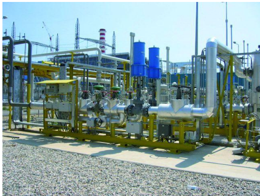
Figura 2 - Estación de regulación y medición para Gas Natural (E.R.M.), aérea.
